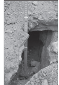
Abb. 2: Einblick in das Entwässerungssystem.
